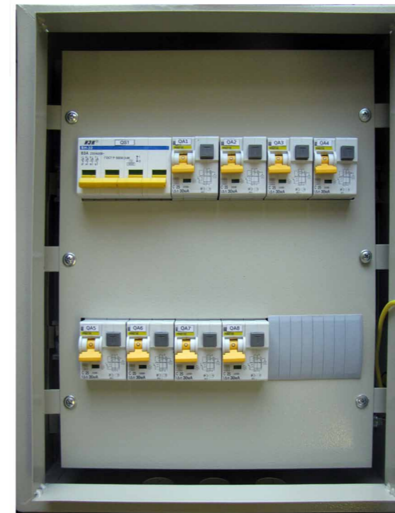
Рис. 1. Общий вид осветительного щитка
